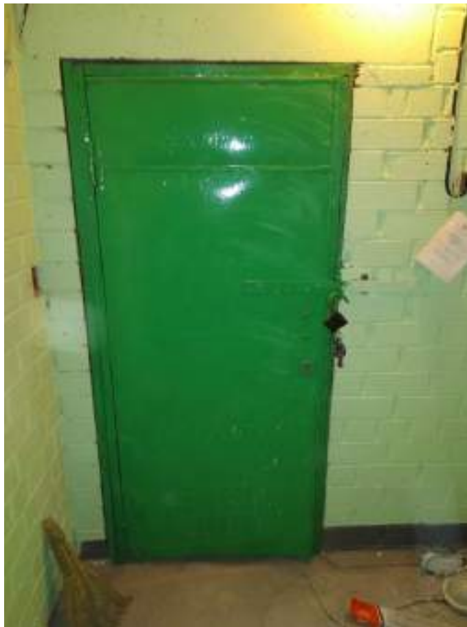
Рисунок 4 – Вход в машинное помещение
